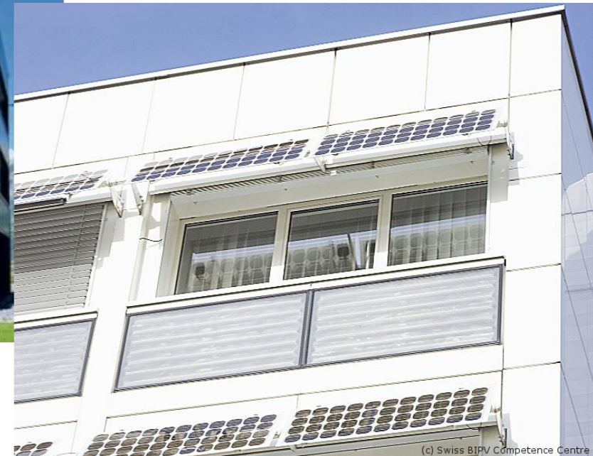
FEAT HQ Lugano PV Sonnenschutz
